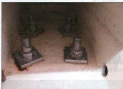
▲ L'état des boulons de quille est crucial. Un peu de corrosion n'est pas rédhibitoire.
