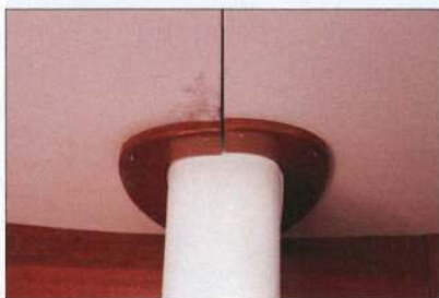
▲ Chaque trace d'humidité est révélatrice d'un défaut d'étanchéité...
