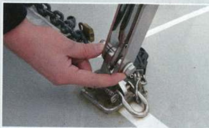
▲ Vérifier la cohérence du montage des cadènes afin de voir si les efforts sont bien répartis.
