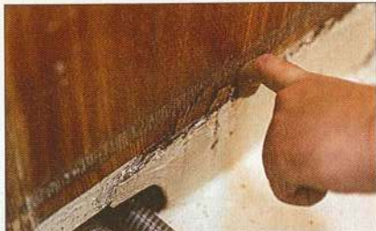
▲ Le délaminage au pied des meubles indique que les fonds ont beaucoup trempé dans l'eau.
