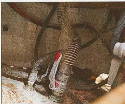
▲ Les vannes doivent être manipulées. Si elles sont dures, ou au moindre doute, on les change.
