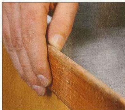
▲ A l'inverse, cette fargue complètement sèche a grand besoin d'un coup de vernis...
